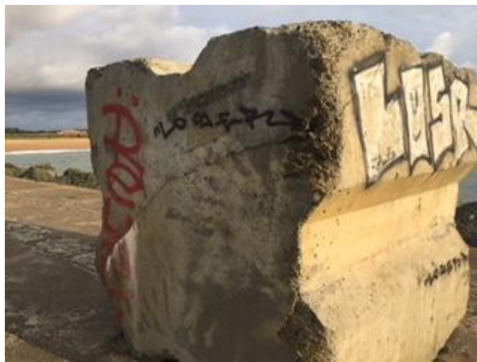
Figure 3 : Photographie exposant les dégâts dus à l'environnement marin
