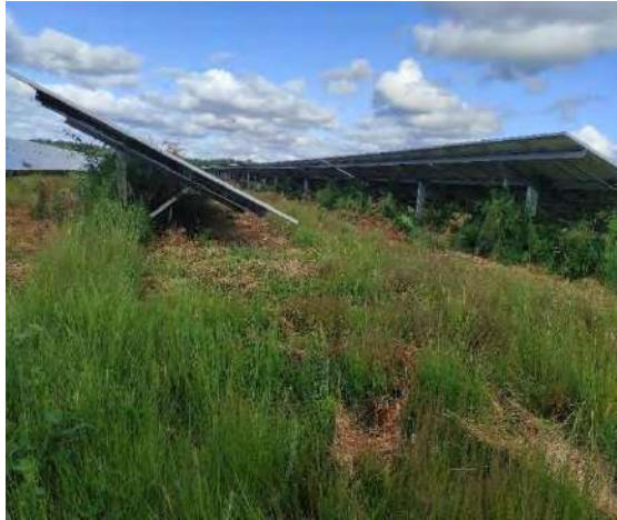
Figure 32 : Fauche raisonnée dans une centrale photovoltaïque
