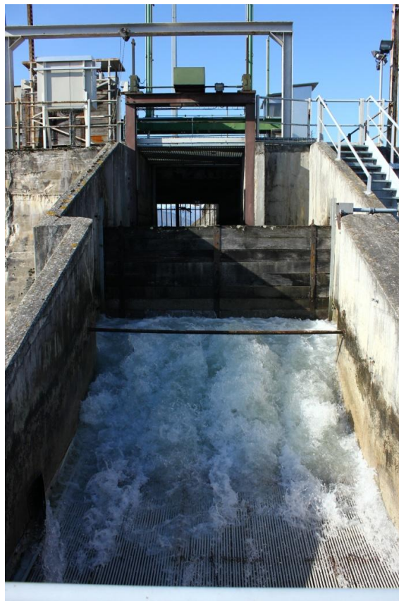
Annexe 2 : Grille inclinée filtrant le débit entrant
