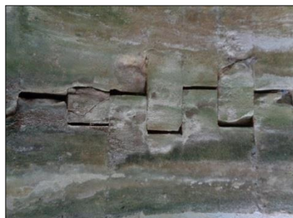
Figure 13. Anfractuosités sur l'intrados de la voûte sur un pont de type (6) (CAPITANIO, 2018)
