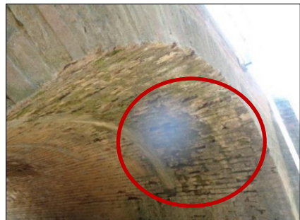
Figure 11. Anfractuosités sur l'intrados de la voûte sur un pont de type (6) (CAPITANIO, 2018)
