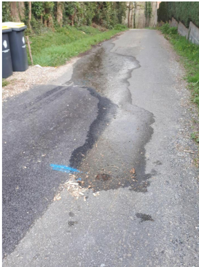
Fuite d'eau à Saint Pierre d'Irube
