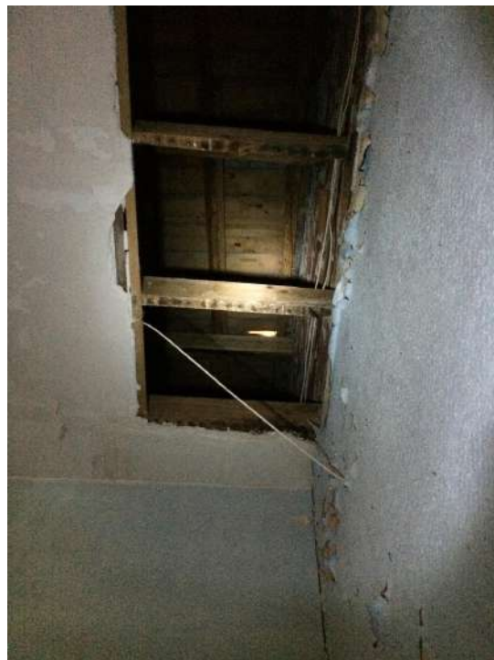
Illustration 23: Trou au plafond étage 1 du bâtiment
