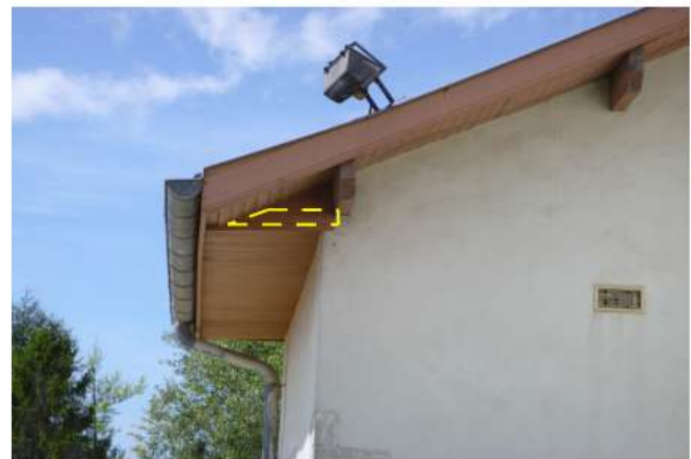
Façade Sud, latte à enlever
