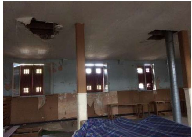
Illustration 22: Salle avec trou au plafond
