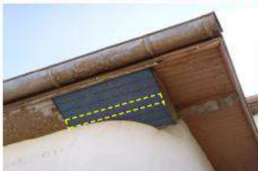
Façade Nord, latte à enlever
