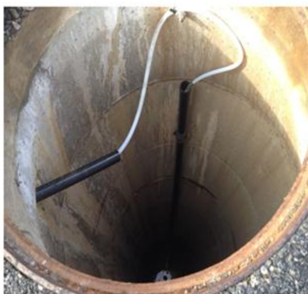
Figure 7: point d'injection du Desinfix dans la STEP
