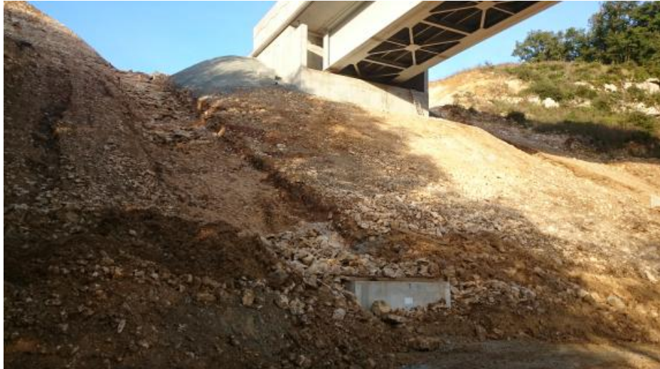
Figure 1. Vue de la culée après l'épisode orageux
