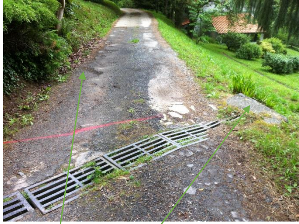
Exutoire second caniveau Affaissements
