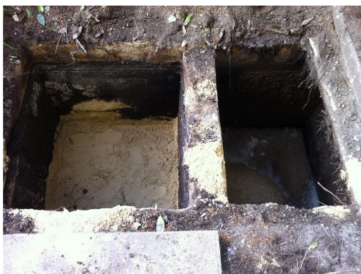
Fosse septique pompée
