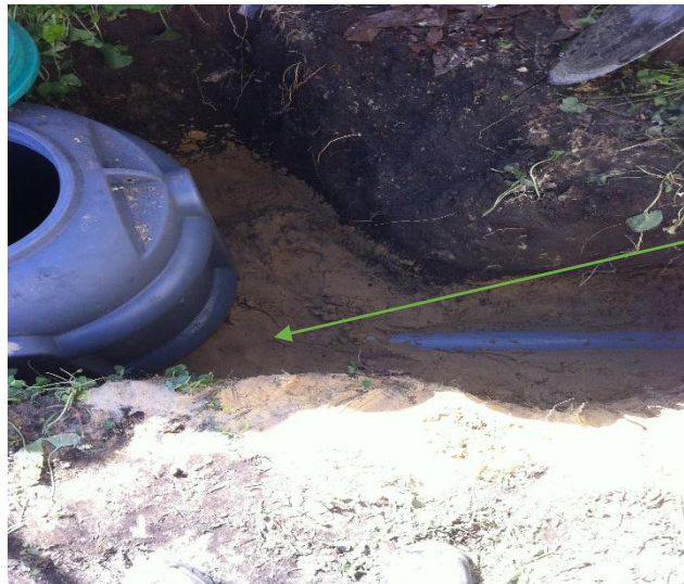
Entrée du poste de relevage
