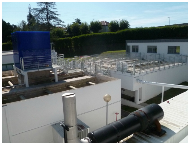
Photo : filtres à sable et décanteurs de la station
