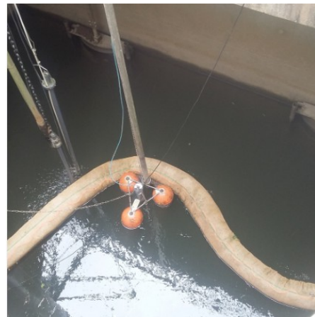
Photo: sondes dans un bassin d'eau brute
