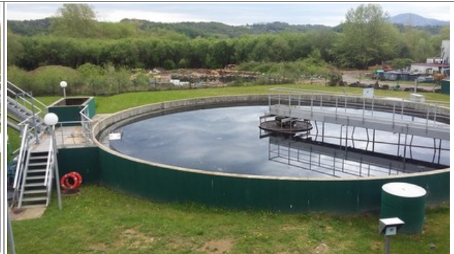
Photo: clarificateur de la step d'Ustaritz
