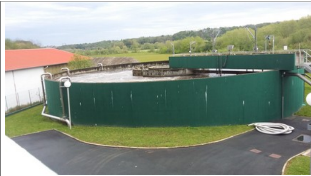
Photo: Bassin d'aération de la step d'Ustaritz
