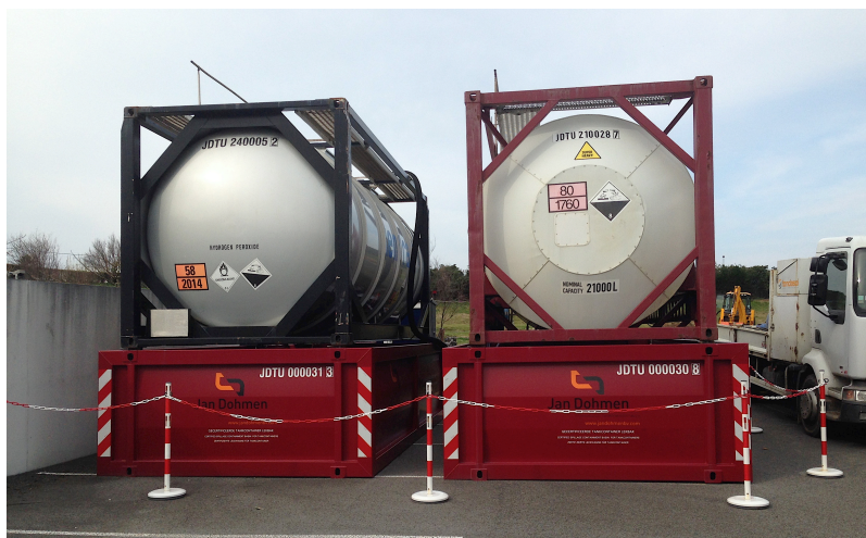
Figure 4. Photo des cuves de stockage des réactifs à la STEP de Marbella
