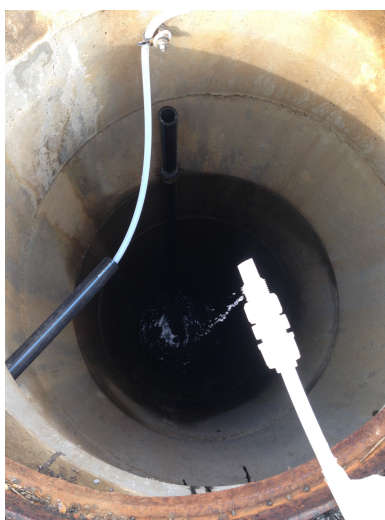
Figure 7. Injection du DEX135 dans la canalisation de sortie de station
